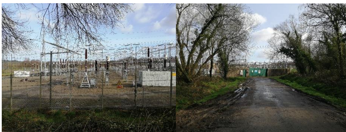
Figure 5 : Vue sur le poste électrique existant de LA MARTYRE
