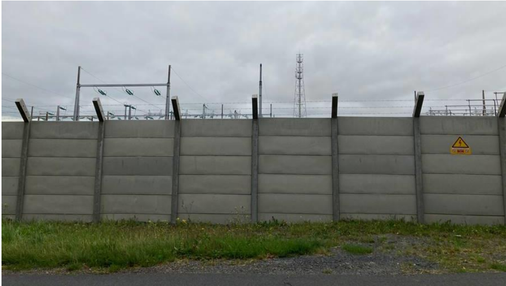
Figure 1 : Exemple de clôture (source : RTE)
